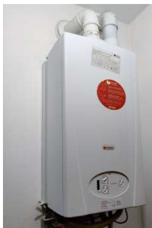
Caldaia a gas interna
