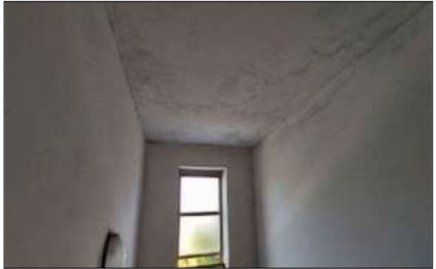
Particolare infiltrazioni copertura
