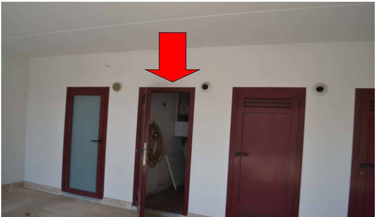
Piano seminterrato: 3 Locali tecnici ( caldaia) con accessi indipendenti dall'abitazione. Nel principale, è presente la caldaia collegata all'abitazione e l'adduzione dell'acqua.
