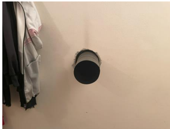
particolare scarico caldaia a pellet
