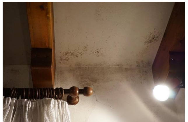
Piano rialzato – infiltrazioni su soffitto lato ovest taverna
