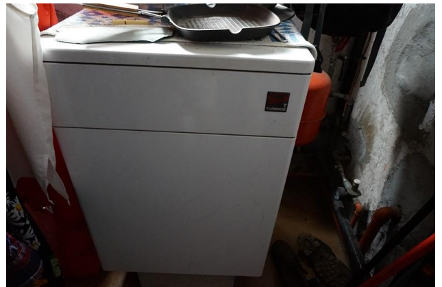
Piano terra – particolare caldaia
