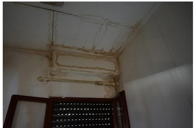
Piano primo – infiltrazioni su parete e soffitto bagno
