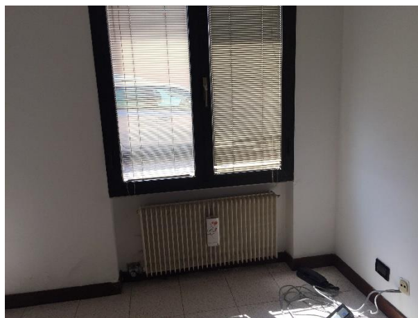
- umidità di risalita uffici
