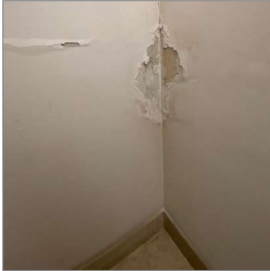
Umidità vano scala condominiale
