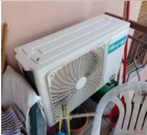
Foto 13: Impianto di condizionamento d'aria
