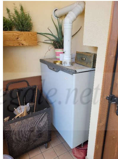
CENTRALE TERMICA ESTERNA
