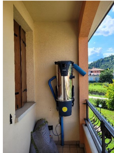
LOGGIA CON ASPIRAZIONE CENTRALIZZATA
