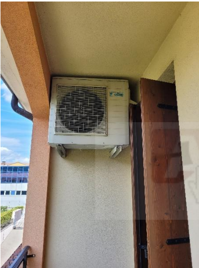
LOGGIA CON IMPIANTO CONDIZIONATORE
