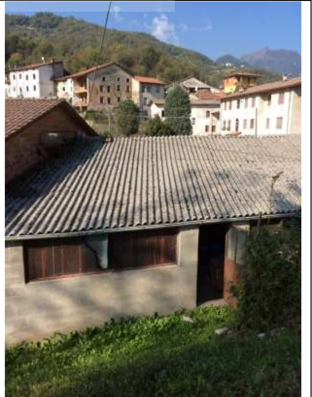
Massiccia presenza di eternit
