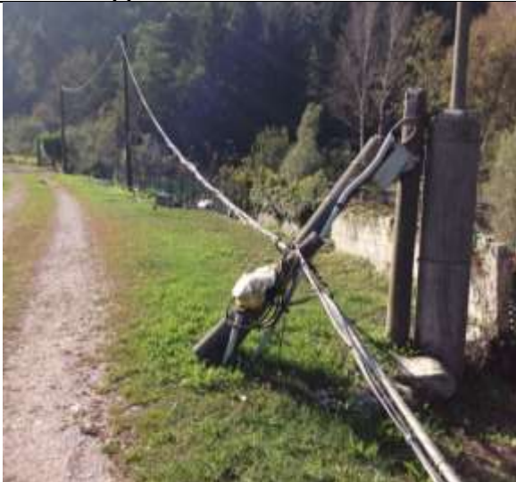
Foto 19: Palo in cls crollato su stradina di accesso
