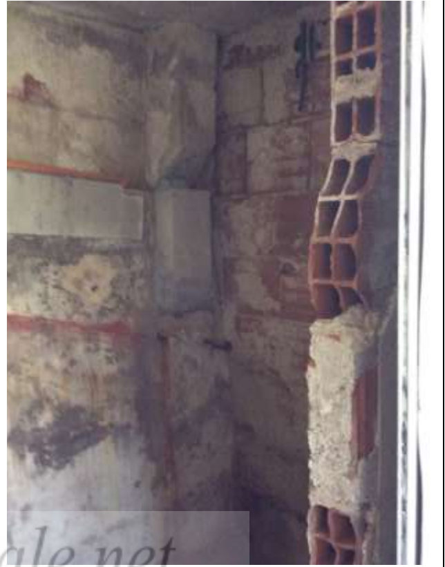
Murature danneggiate all'interno dei locali incubatoio (sub 5)
