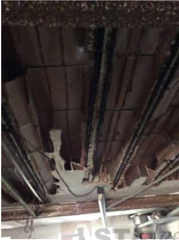
Ferri d'armatura sporgenti e sfondellamento dei solai (sub 6)
