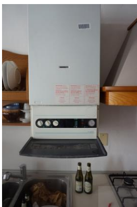
Piano primo – Caldaia inserita su zona cucina
