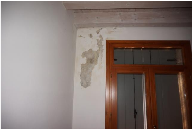
Piano primo – Particolare ammaloramento parete ovest camera
