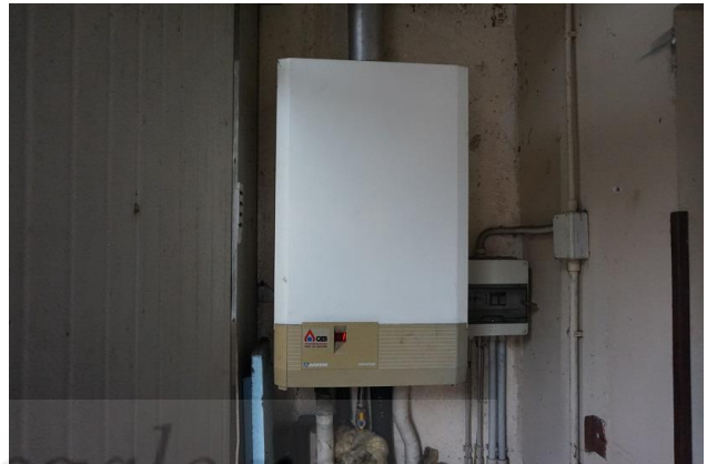
Caldaia su parete nord area esterna coperta ad ovest
