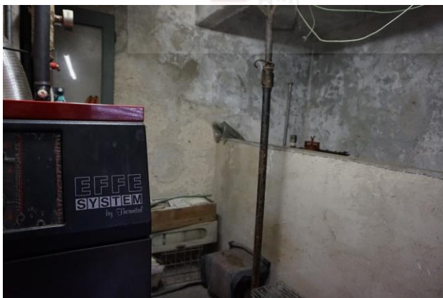
Piano interrato – Caldaia autonoma su C.T. comune
