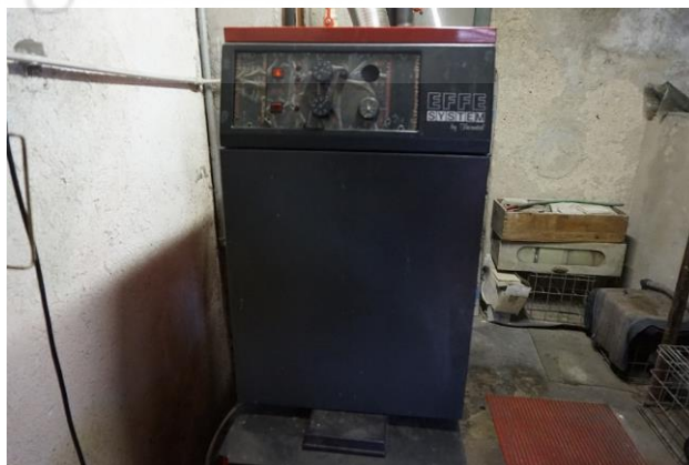
Piano interrato – Caldaia autonoma su C.T. comune
