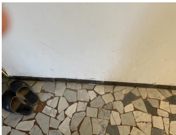
particolare battiscopa e pavimentazione danneggiata
