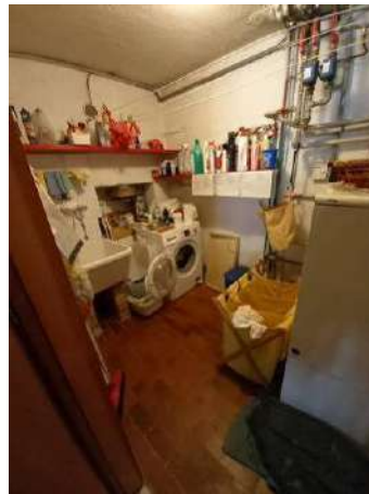
VISTA C.T./LAVANDERIA P. INT.
