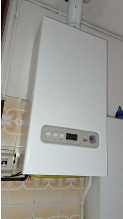
Piano primo – Caldaia all'interno del w.c./lavanderia
