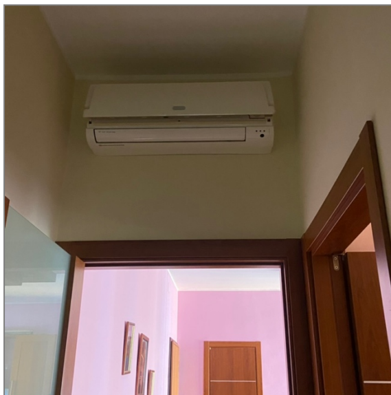
Split aria condizionata zona notte
