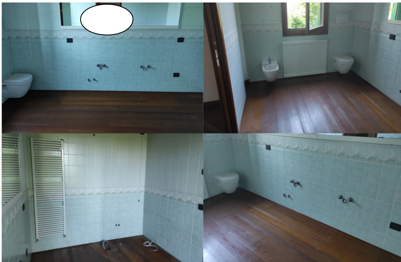
Fig.76-77-78-79- STATO BAGNO PADRONALE CAMERA DOPO ASPORTAZIONE MOBILIO -MAGGIO 2023
