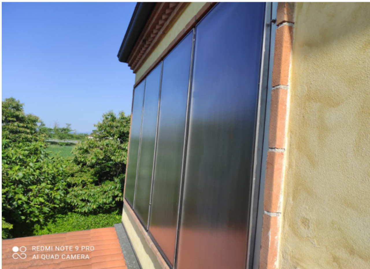
Fig.89- IMPIANTO FOTOVOLTAICO-PANNELLI SULLA PARETE SUD;
