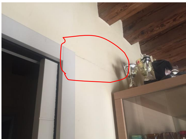
- Particolare crepo soggiorno
