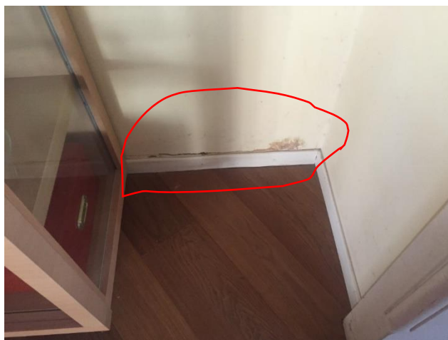
Particolare infiltrazioni soggiorno
