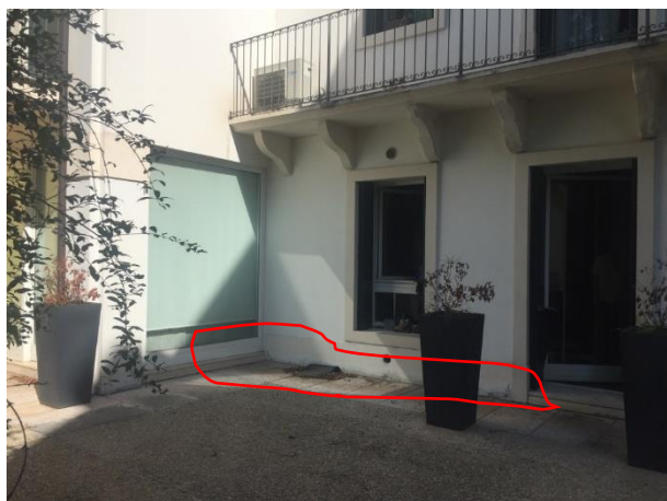
- Particolare umidità muro esterno
