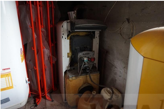
Piano seminterrato: c.t. con caldaia (dismessa)
