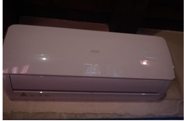
Piano primo: climatizzatore in soggiorno
