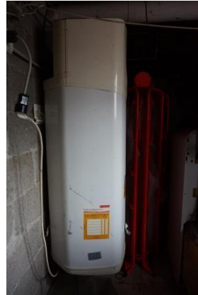
Piano seminterrato: boiler elettrico
