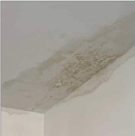
Infiltrazioni dal coperto
