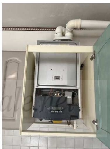
Interno abitazione – Caldaia
