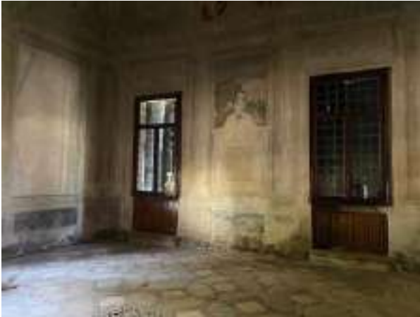
Umidità di risalita e perdita della pellicola pittorica.
