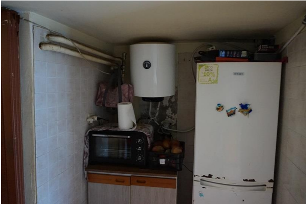
Piano terra – Bollitore acqua calda sanitaria in cucina
