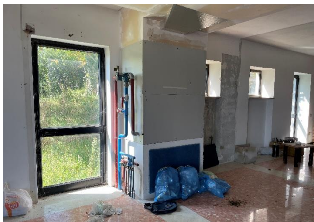
Vista dell'impianto di riscaldamento all'interno della sala bar
