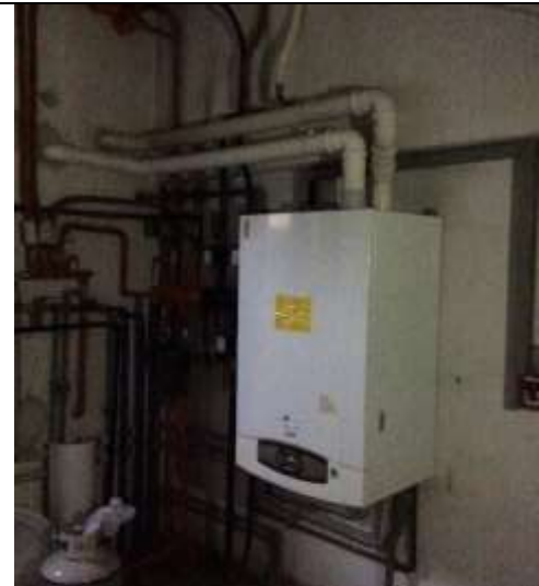
Foto 14: P. semin. - C.T. e caldaia
