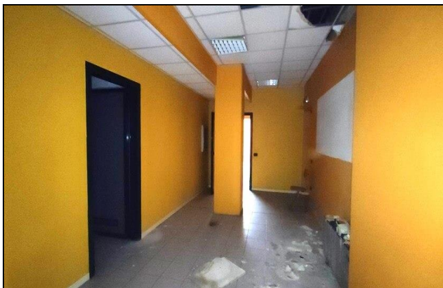
Disimpegno con controsoffitto rovinato
