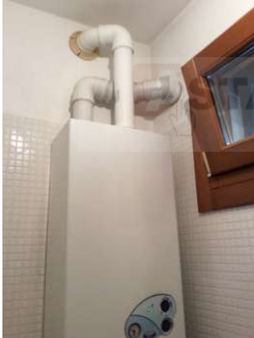
Foto 9: P1: Centrale termica: caldaia
