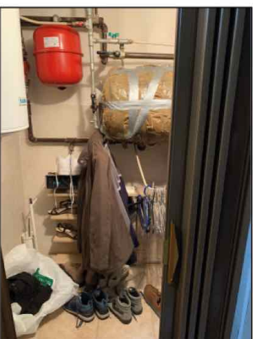
centrale termica pS1
