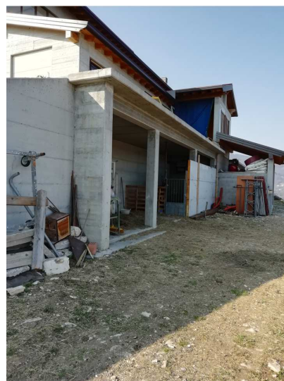
Vista est – locali abusivi
