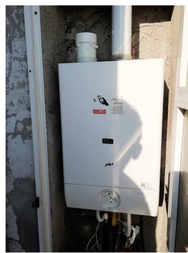
Caldaia esterna per ACS
