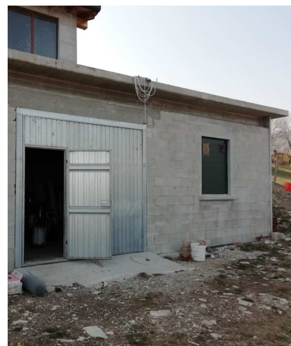
Vista est – locali abusivi
