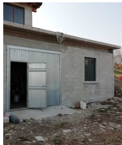
Vista est – locali abusivi
