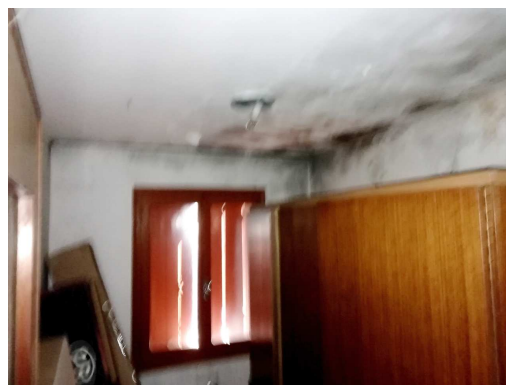
Stanzino al piano secondo con segni di degrado per umidità
