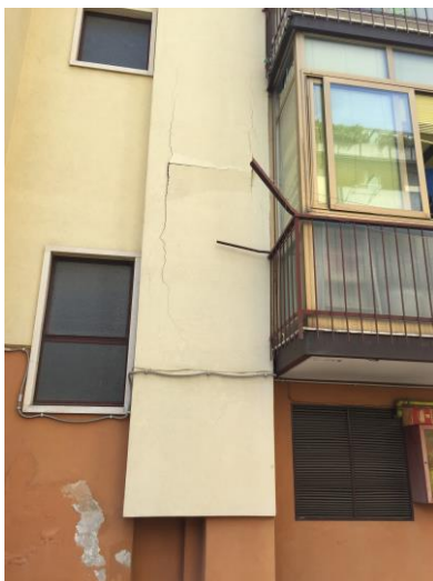
- Particolare scrostazioni condominiale
