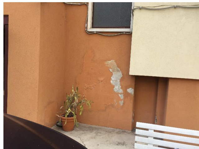
- Particolare scrostazioni condominiale
