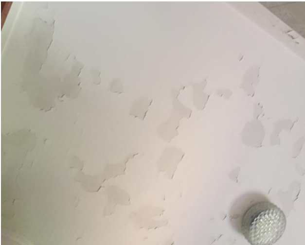
- Particolare scrostazioni soffitto bagno
