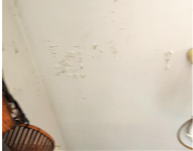
- Particolare umidità soffitto cucina
