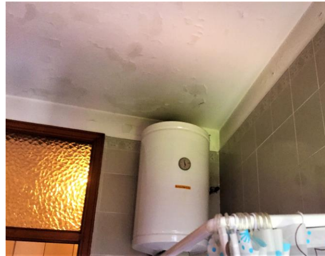
- Particolare scrostazioni soffitto bagno
