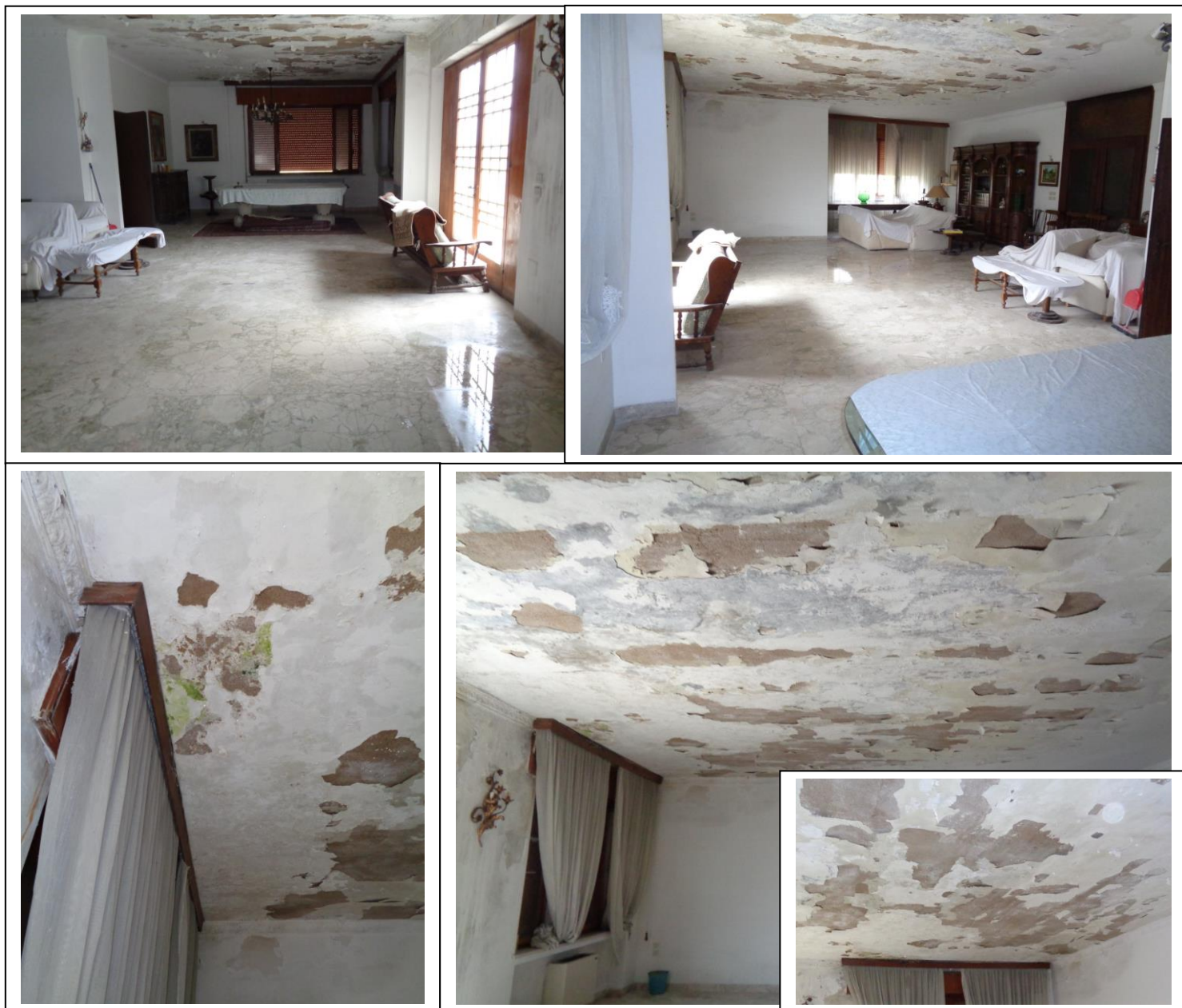
FOTO infiltrazioni nel soggiorno provenienti dalla terrazza al piano primo
