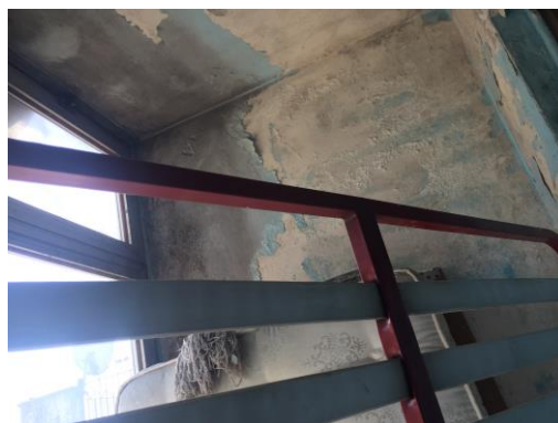
- distacco colore-intonaco loggia
