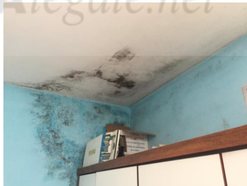
- presenza di infiltrazioni - muffa camera
