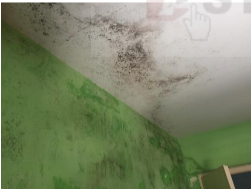
- presenza di infiltrazioni- muffa camera
