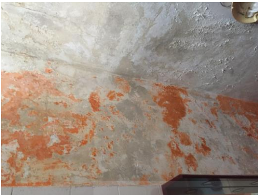
- infiltrazioni soffitto bagno
