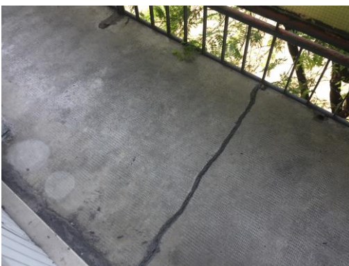
presenza di crepo pavimento terrazza
