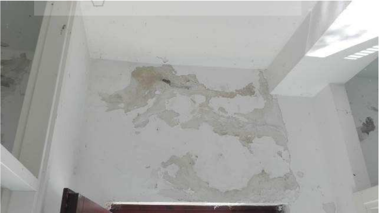
Figura 110. Segni di umidità, infiltrazioni e ammaloramento intonaci.
