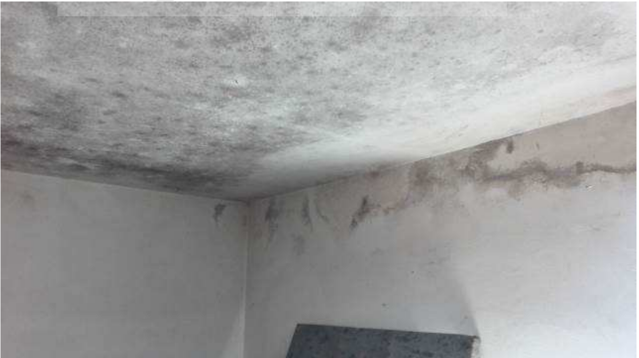
Figura 94. Segni di infiltrazioni, muffe ed umidità, locale sotto terrazzo torretta.
