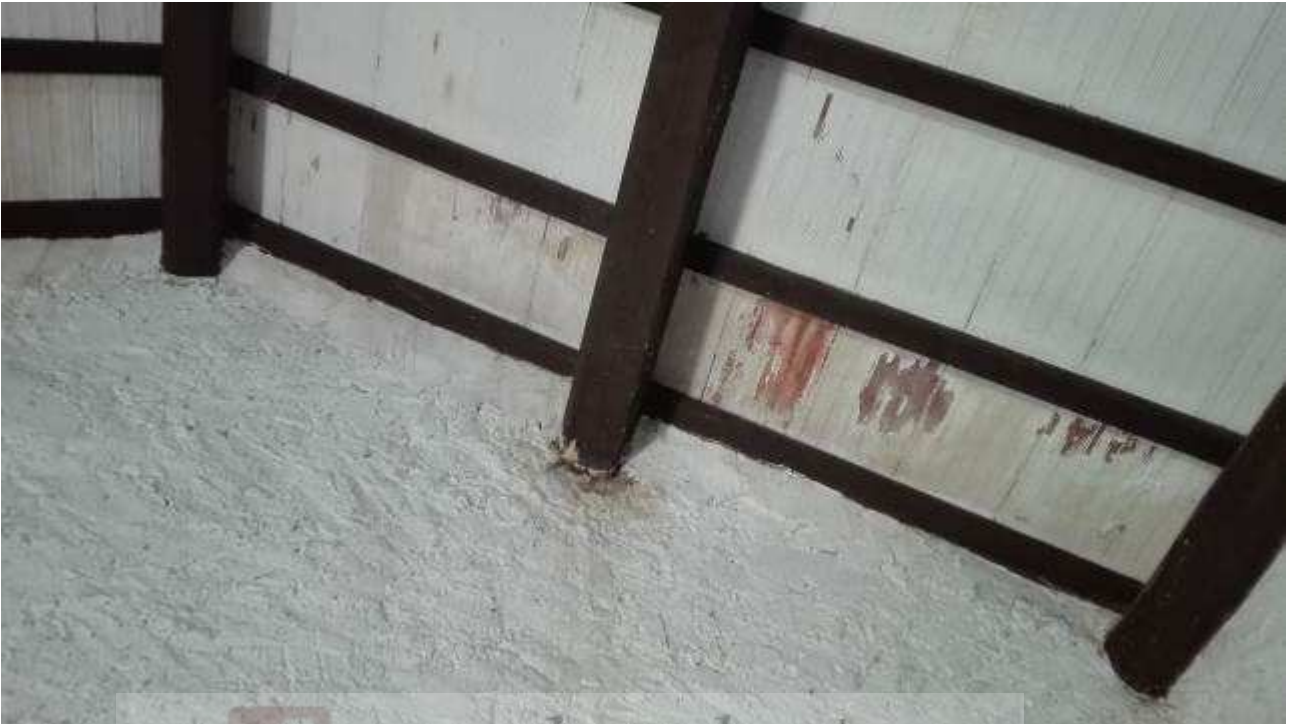
Figura 101. Segni di infiltrazioni copertura ripostigli n-e.
