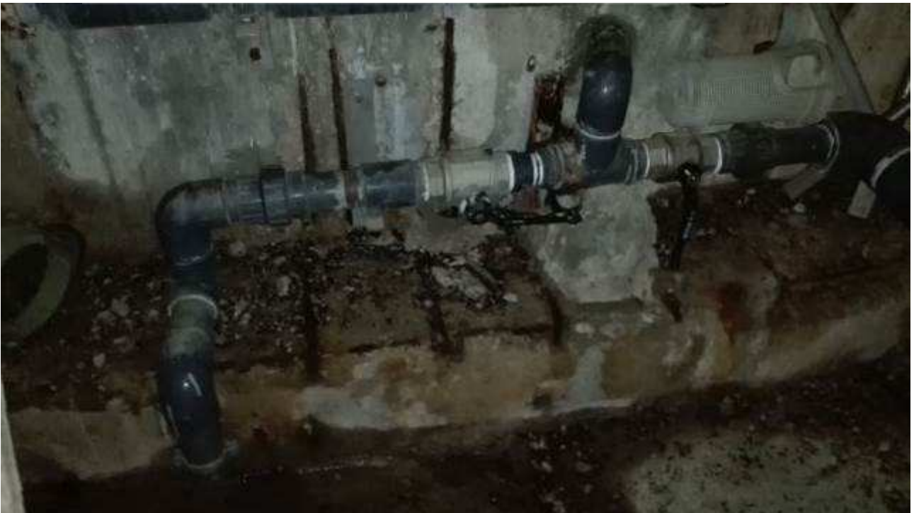
Figura 114. Segni di umidità, infiltrazioni e ammaloramento cls e barre d'armatura.
