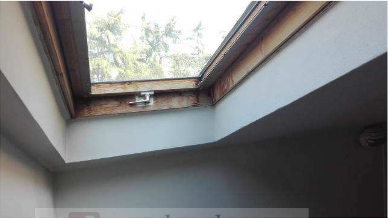
Figura 91. Segni di infiltrazioni ed umidità.
