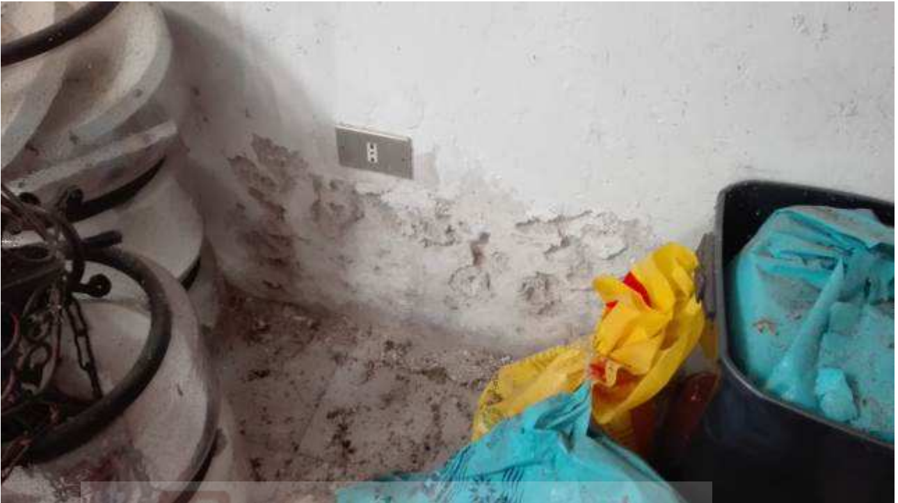
Figura 99. Umidità di risalita e ammaloramento intonaci ripostigli n-e.
