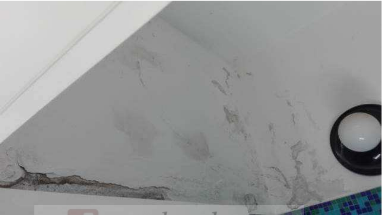
Figura 111. Segni di umidità, infiltrazioni e ammaloramento intonaci.
