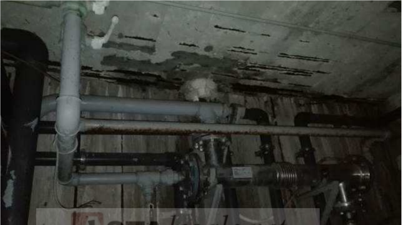
Figura 113. Segni di umidità, infiltrazioni e ammaloramento cls e barre d'armatura.
