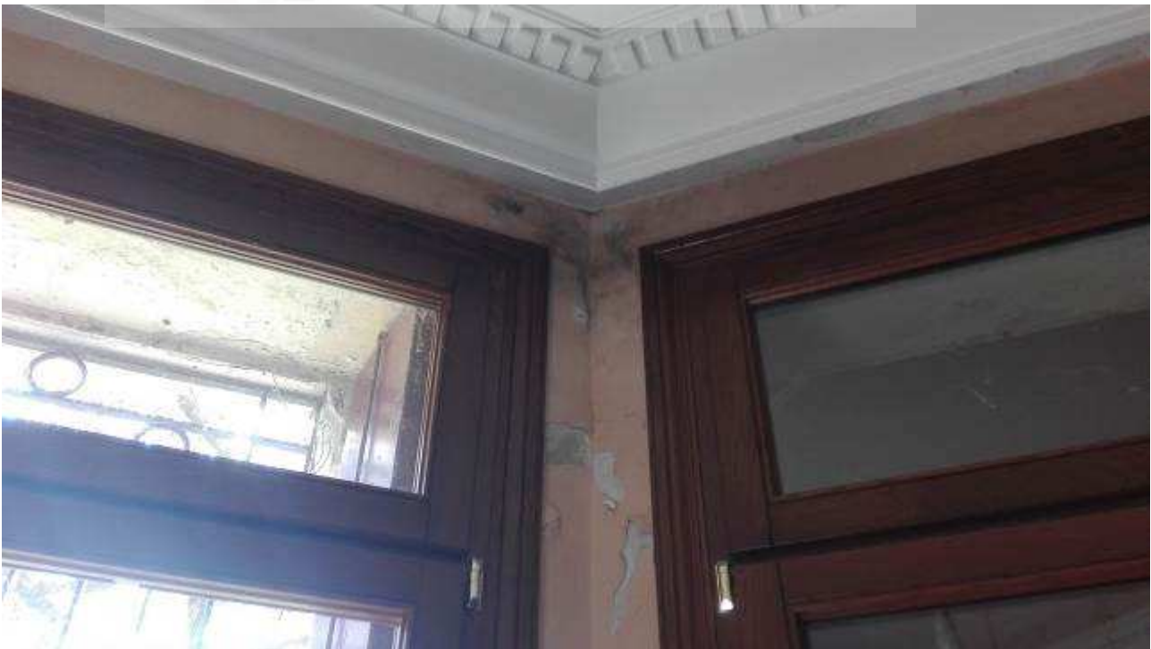
Figura 90. Segni di infiltrazioni ed umidità.
