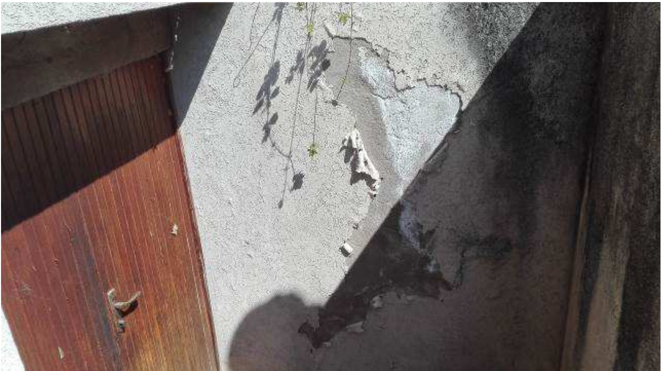
Figura 34. Accesso cantina da est e umidità-infiltrazioni murature.
