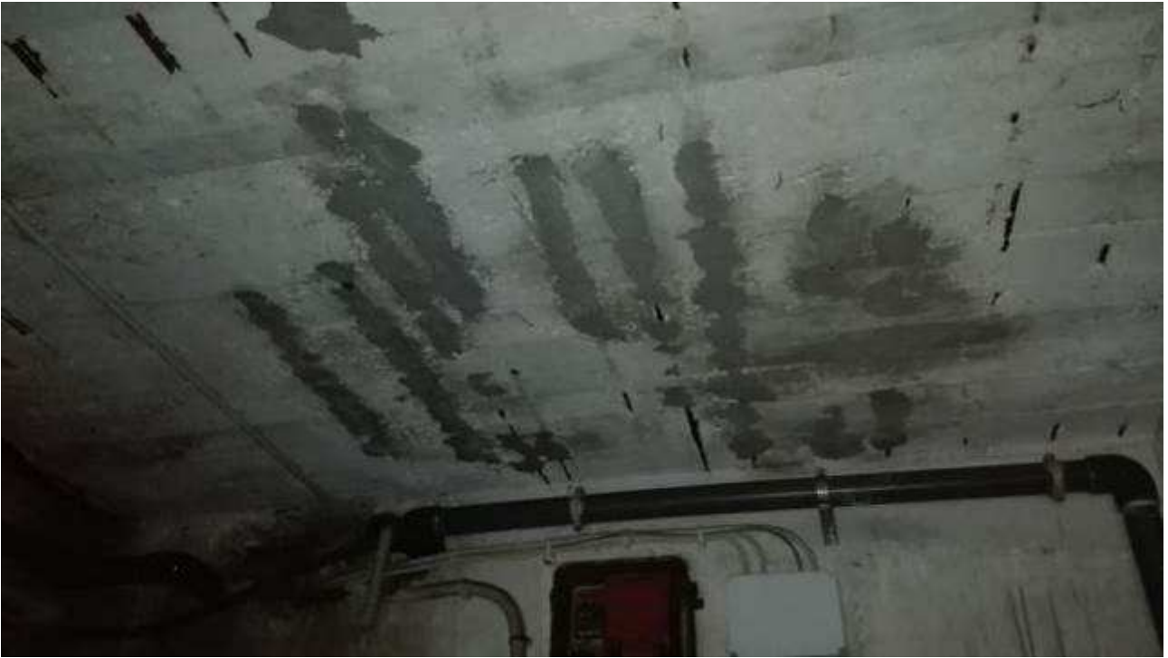
Figura 115. Segni di umidità, infiltrazioni e ammaloramento cls e barre d'armatura.
