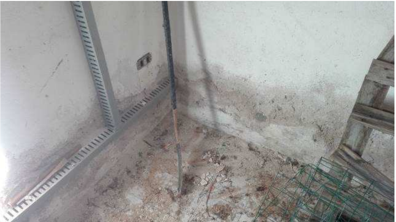
Figura 98. Umidità di risalita e ammaloramento intonaci ripostigli n-e.
