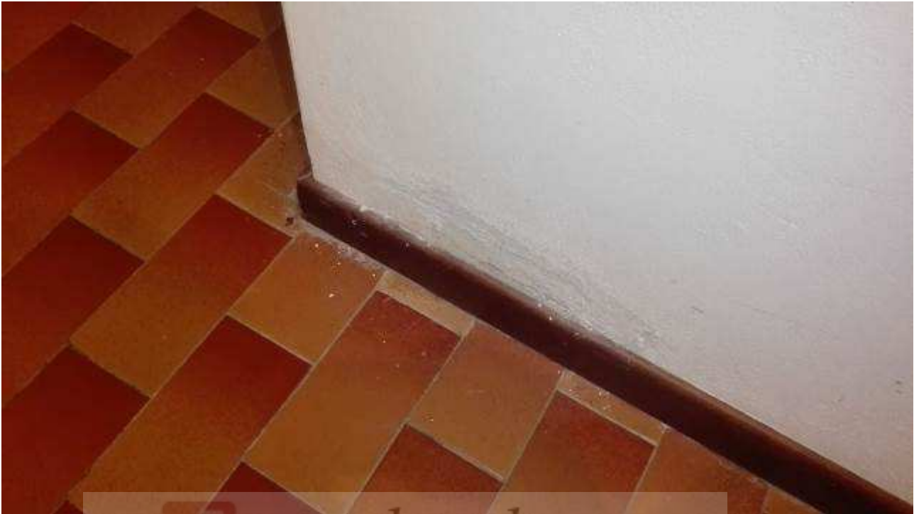
Figura 89. Umidità di risalita murature.
