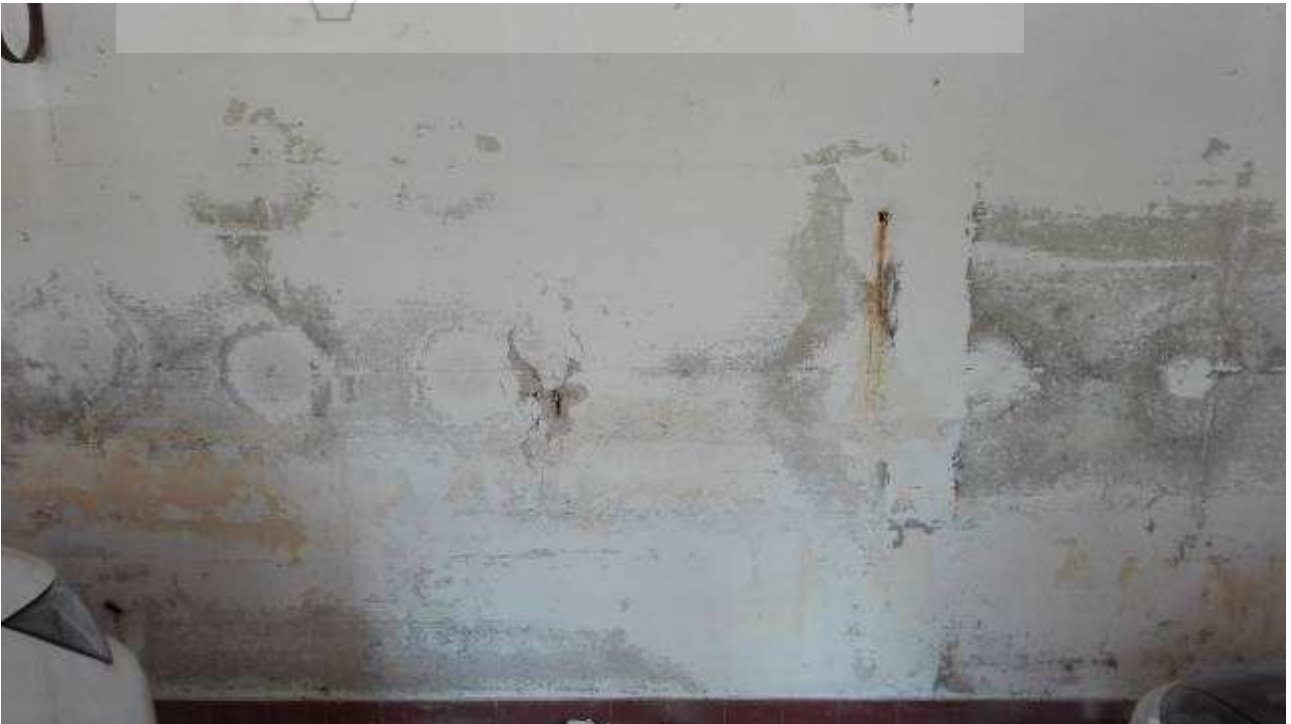
Figura 120. Segni di umidità, infiltrazioni e ammaloramento cls e barre d'armatura.
