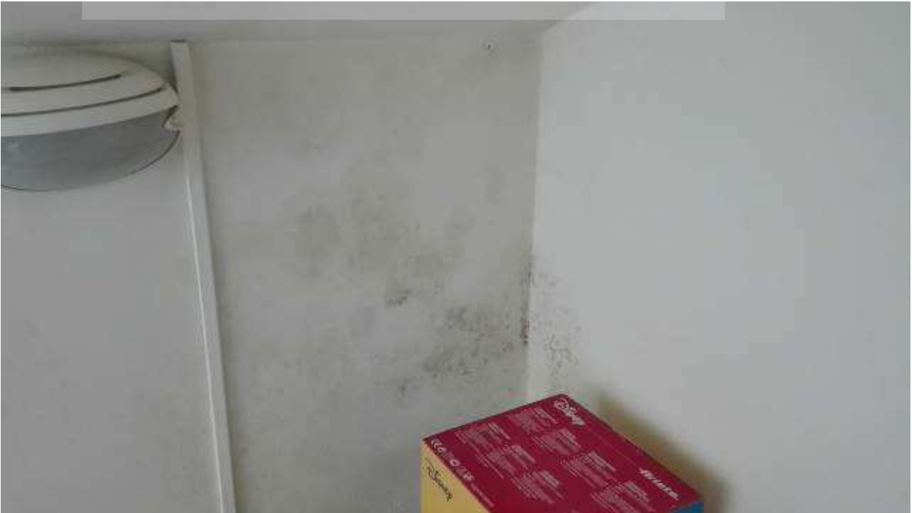
Figura 92. Segni di muffe ed umidità.
