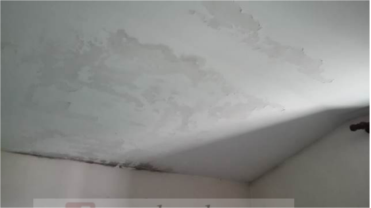
Figura 27. Segni infiltrazioni umidità.
