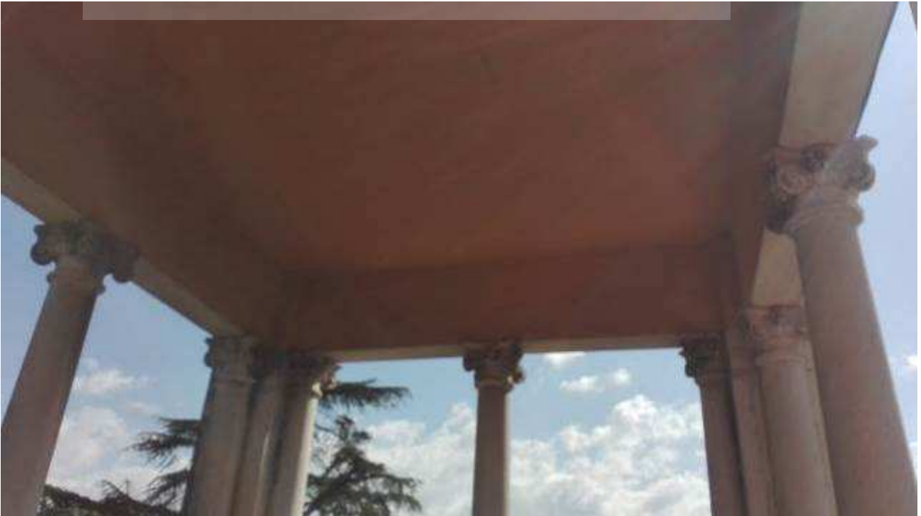
Figura 86. Soffitto terrazzo piano quarto.
