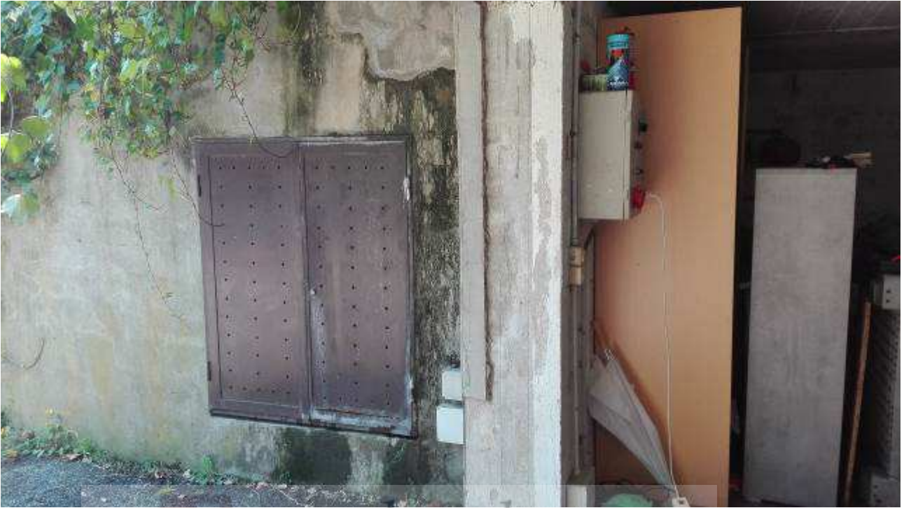
Figura 121. Nicchia-armadio metallico per bombole gas a servizio della villa
