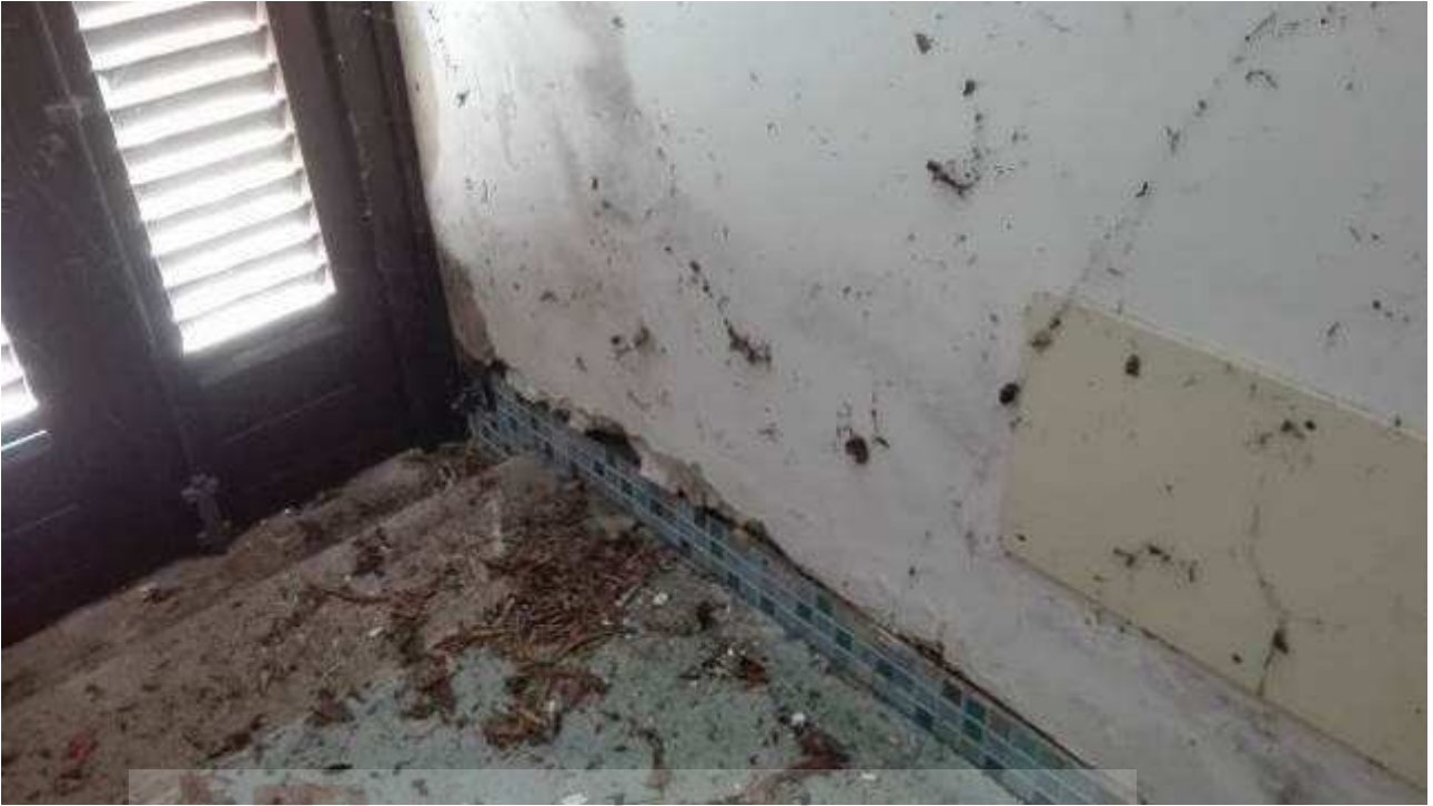
Figura 109. Segni di umidità, infiltrazioni e ammaloramento intonaci.
