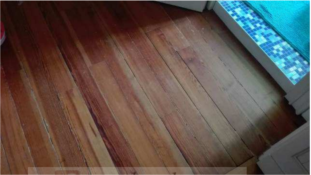
Figura 93. Deterioramento e vetustà pavimenti in legno.
