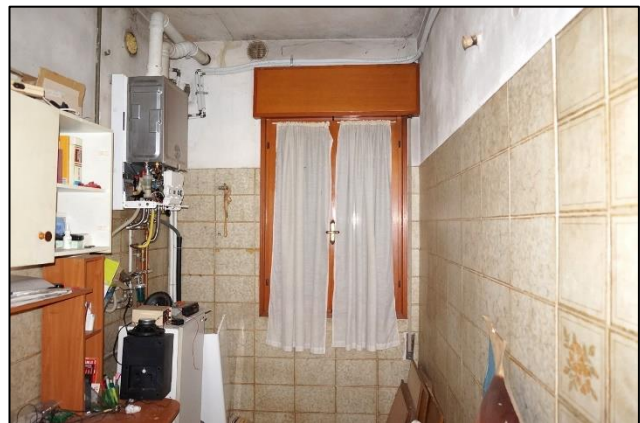
foto 14- Cucinino con centrale termica
