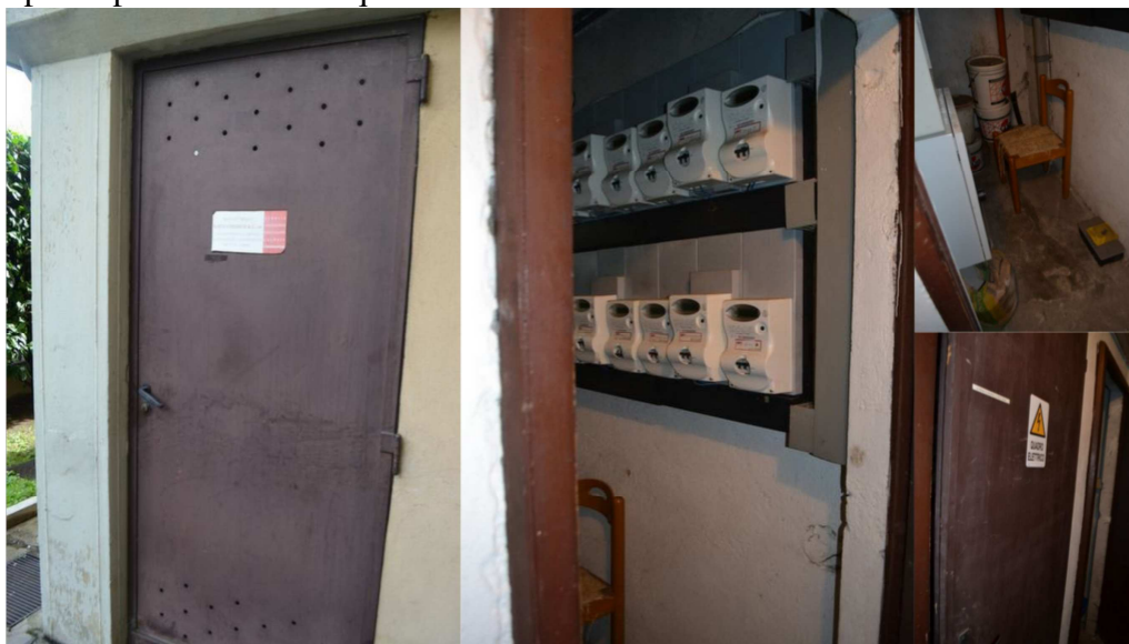
Figure 41-42-43-44-Vano caldaia condominiale centralizzata e vano contatori elettrici.
