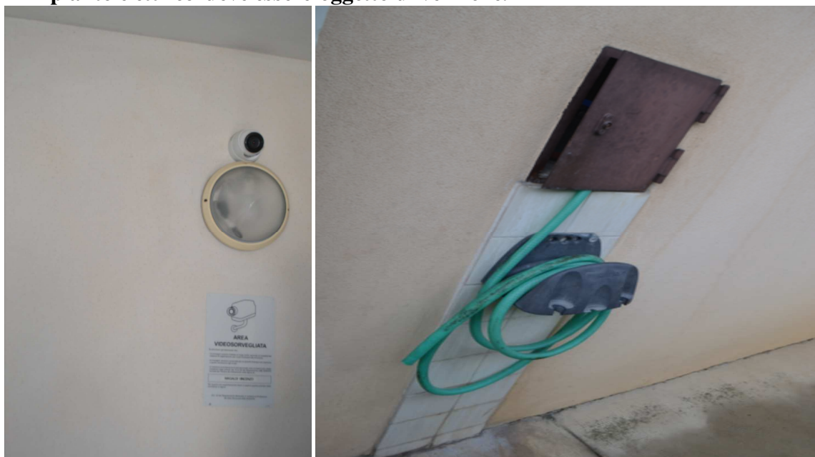
Figure 45-46- È presente un sistema di videosorveglianza e impianto per adduzione idrica a livello condominiale, esterno.
