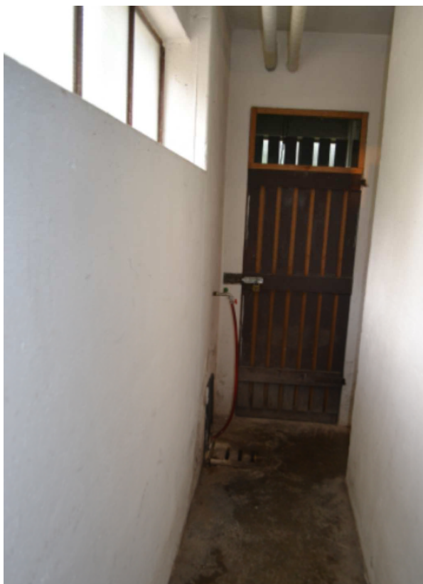
Figura 47 -Impianto per adduzione idrica a livello condominiale, interno nella zona cantine.
