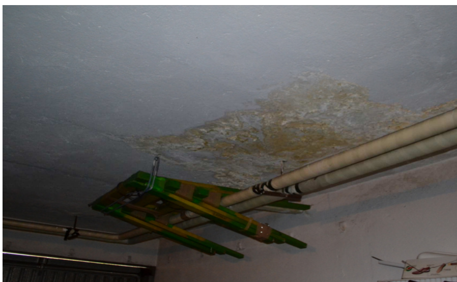
Figure 57-58-59 – Interno Autorimessa condominiale -dettaglio illuminazione- problemi infiltrazioni;
