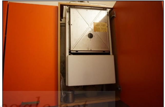
Caldaia non funzionante
