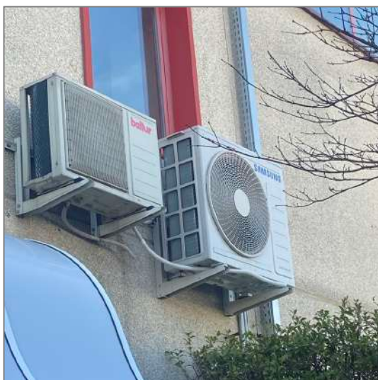
Unità esterne condizionatori
