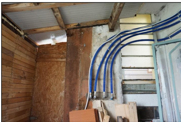
foto 21 - interno della centrale termica
