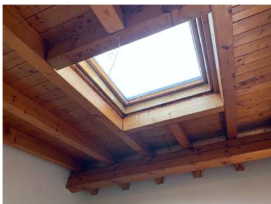
Dettaglio soffitto cucina.
