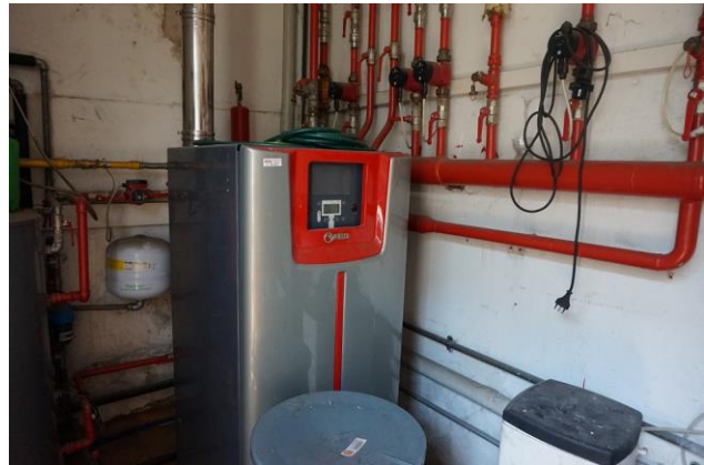
Piano terra – Locale C.T. e particolare caldaia
