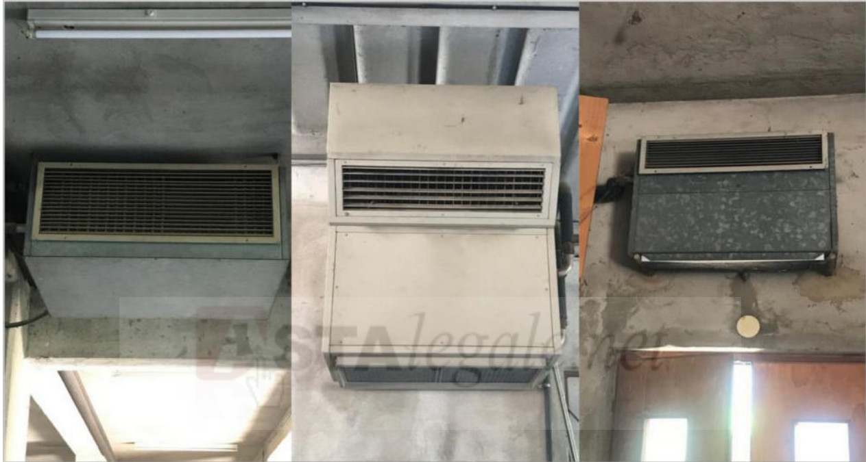
Fig.82-83-84-Interno laboratori- Ventilconvettori presenti in ognuno dei tre laboratori;
