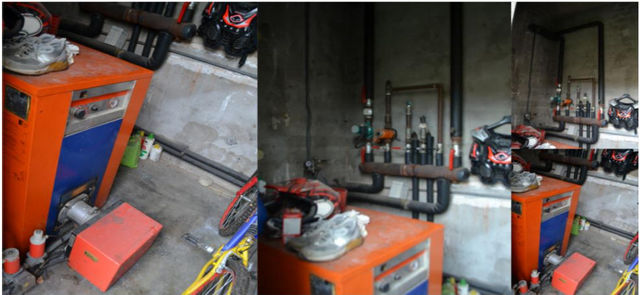
Fig.85-86-87-88- Locale caldaia in comune con l'appartamento al piano primo sub.4.
