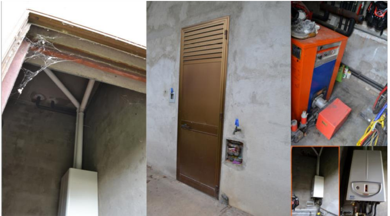
Figure 64-65-66-67-Vano caldaia ubicato al piano terra.
