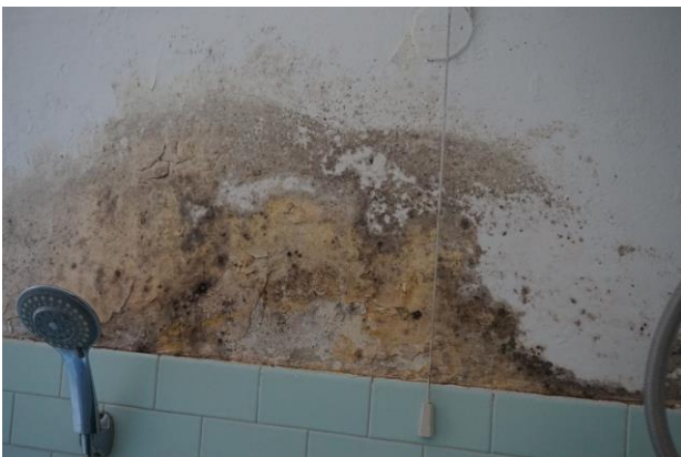
Piano Primo – Particolare tracce umidità
