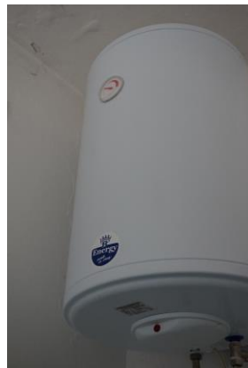
Piano Primo – Bollitore elettrico in bagno
