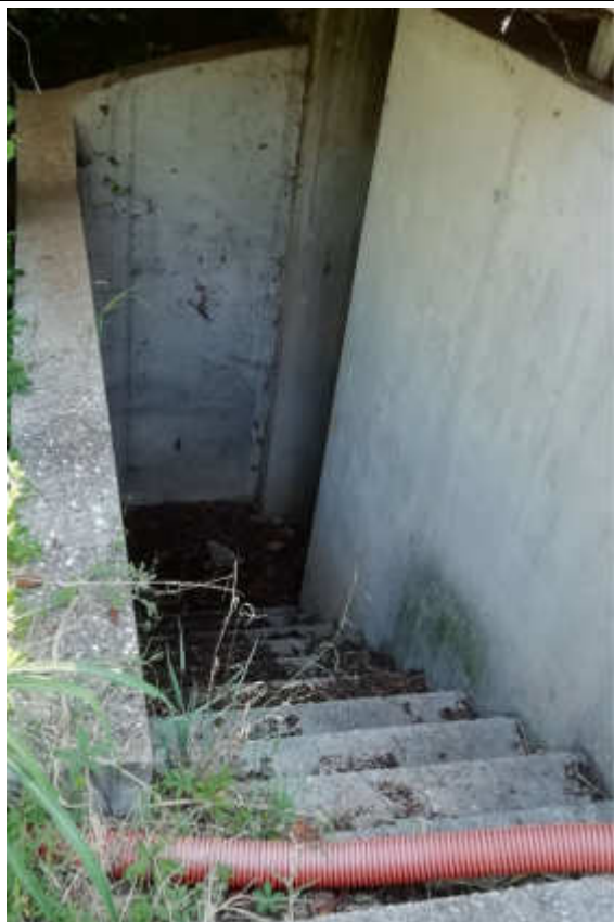
Accesso vasca antincendio
