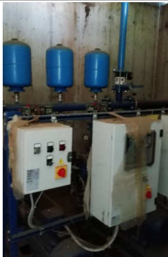
Centralina impianto antincendio
