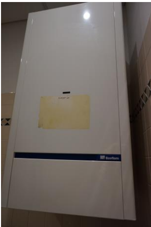
Piano Terzo – Particolare caldaia ufficio
