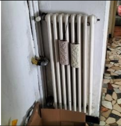
Foto 11: Appartamento P1 Dettaglio termosifone
