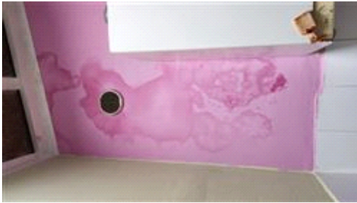
Particolare infiltrazioni d'acqua dal tetto
