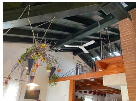
Foto 13. Vista soppalco da soggiorno (lo stato autorizzato prevede la realizzazione di un solaio piano, non travi a vista)
