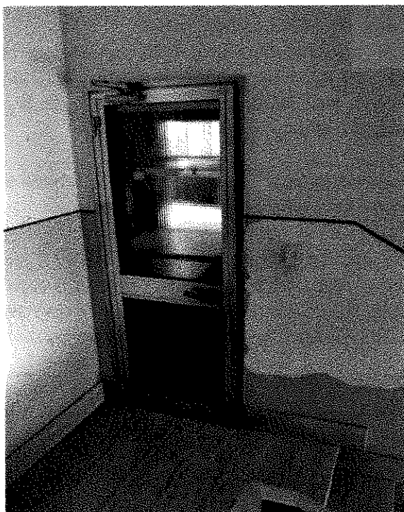
Figura 85- N.B. LA PORTA DI ACCESSO PEDONALE all'autorimessa dal vano scale del condominio, non risulta a norma di legge; manca la porta tagliafuoco che compartimenta gli ambienti in caso di incendio, in particolare protegge il vano scale da eventuali incendi nelle autorimesse. Per CPI, dovrebbe essere una porta REI ;
